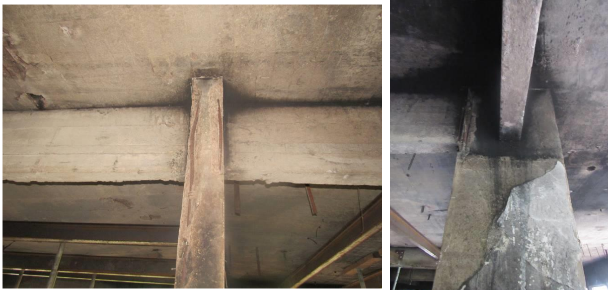
Figura 12 – Deslocamento do concreto na região de cobrimento e deformação da armadura dos pilares (a) P33 e (b) P34
