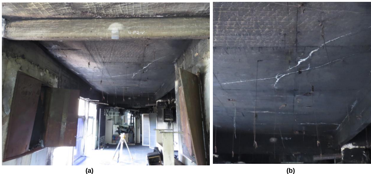
Figura 8 – Imagens registradas no quarto pavimento: (a) acesso às alas do pavimento; (b) detalhe das crostas brancas na laje
