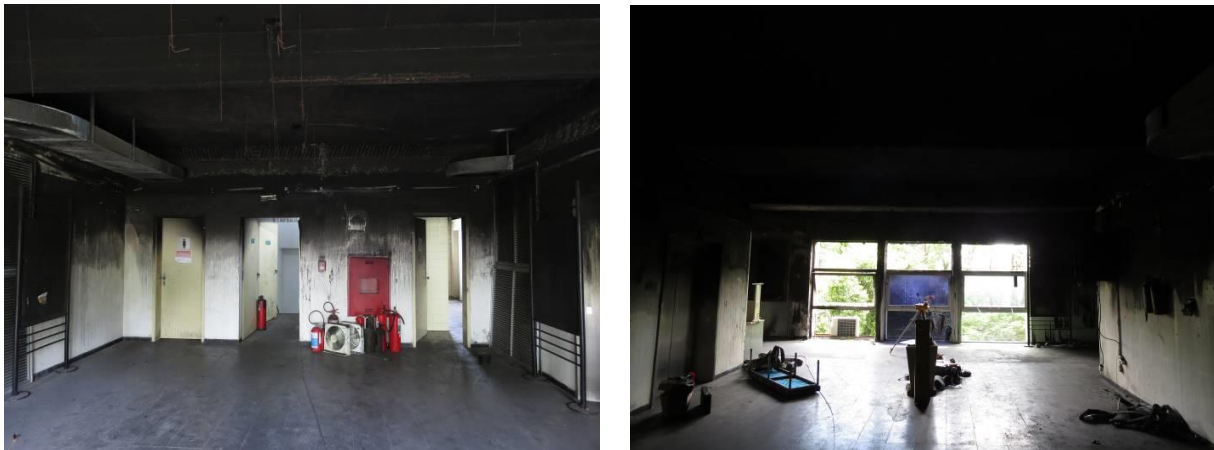
Figura 6 – Imagens registradas no saguão do quarto pavimento da edificação
