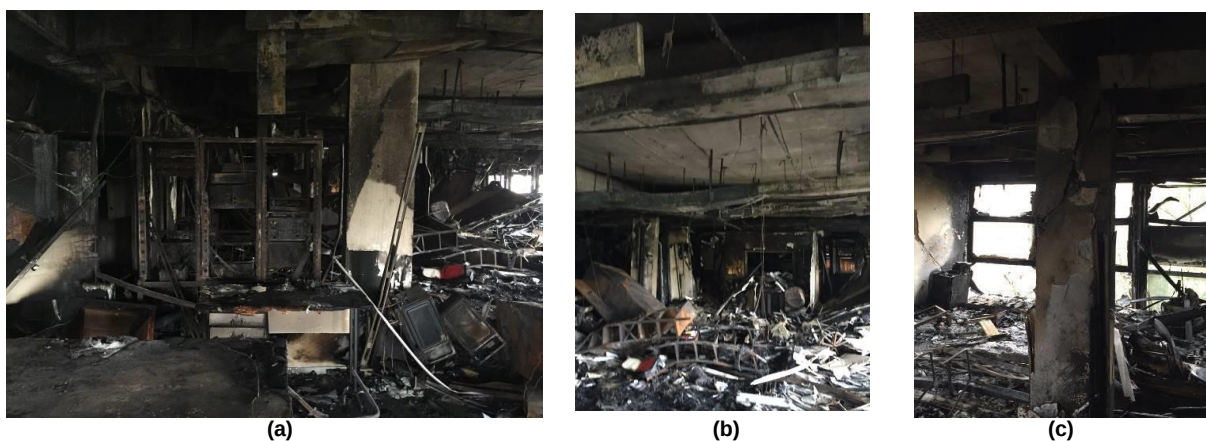
Figura 3 – Imagens registradas no quarto pavimento da edificação dois dias após o sinistro
