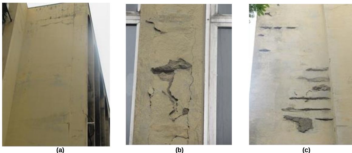
Figura 16 – Fissuras e deslocamento do revestimento de argamassa na fachada
