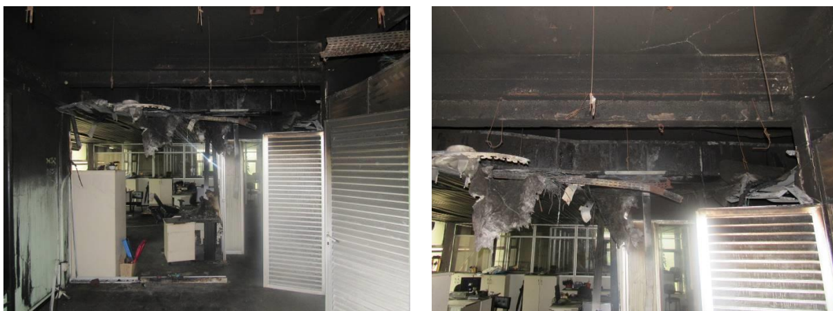
Figura 9 – Imagens registradas na divisa do saguão com a ala leste (viga V37)
