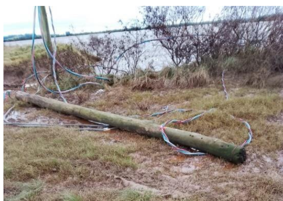
Foto 10 - Danos na estrutura de energia elétrica dos assentamentos no município de Manoel Viana, Regional de Bagé
