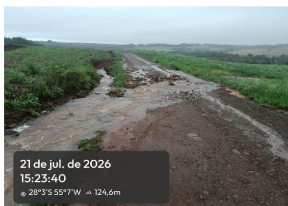
Estrada danificada pelo excesso de chuvas em Roque Gonzales/RS.
