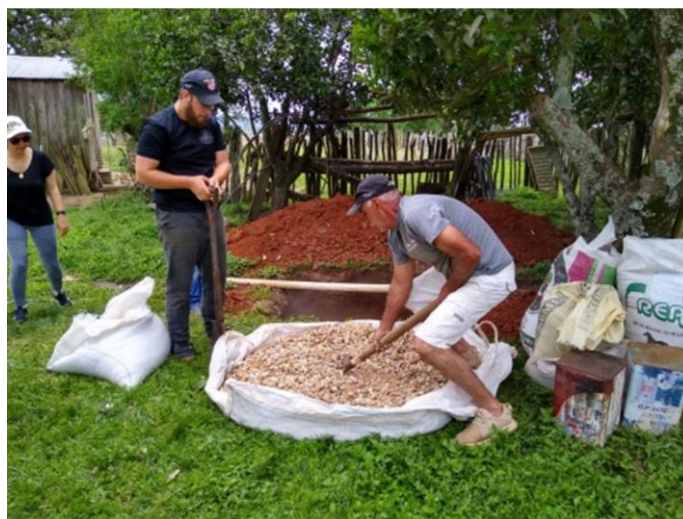
Tratamento de água residual.
