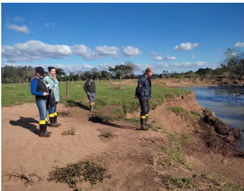
Verificação dos impactos das chuvas para o planejamento da recuperação de área de preservação permanente, em Taquara (agosto/2024).
